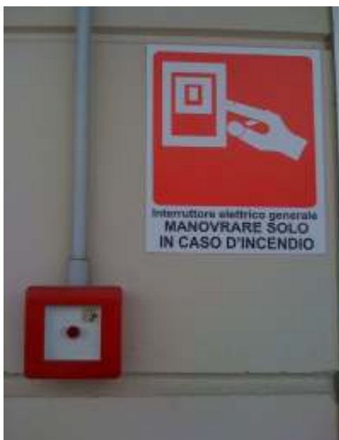
PULSANTE ALLARME INCENDIO
